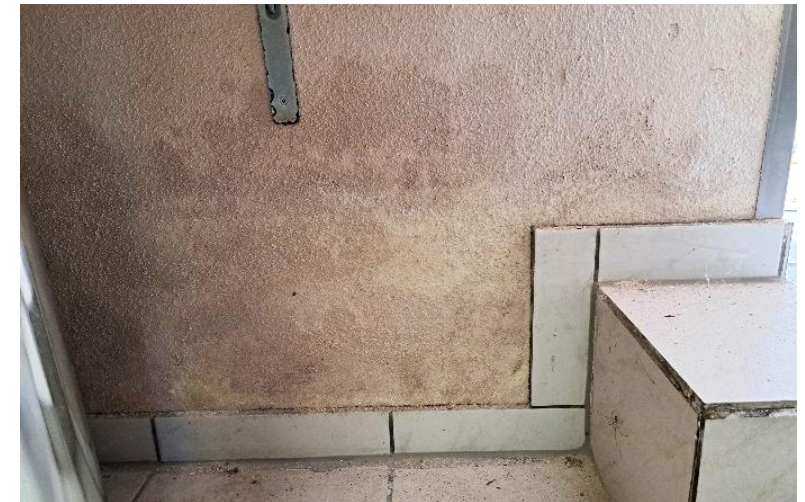
Abb.: Ausblühungen in Kellerwand
