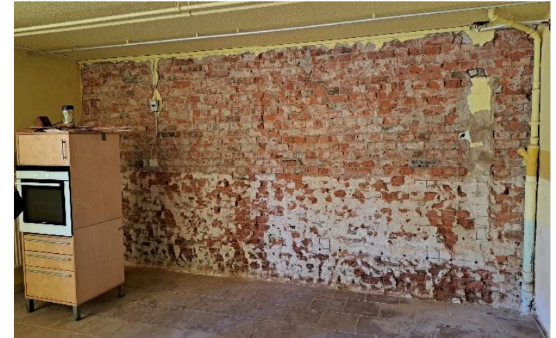
Abb.: Feuchtigkeit in Kellerwand
